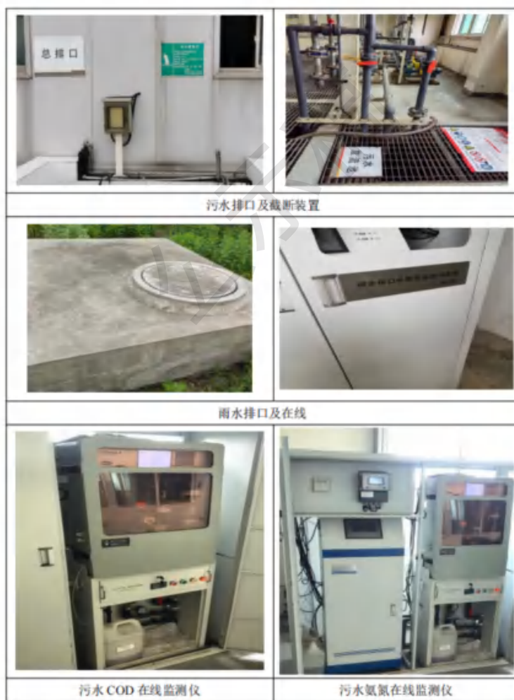
图 6.6-4 雨污水总排口及控制阀门、在线监测装置
