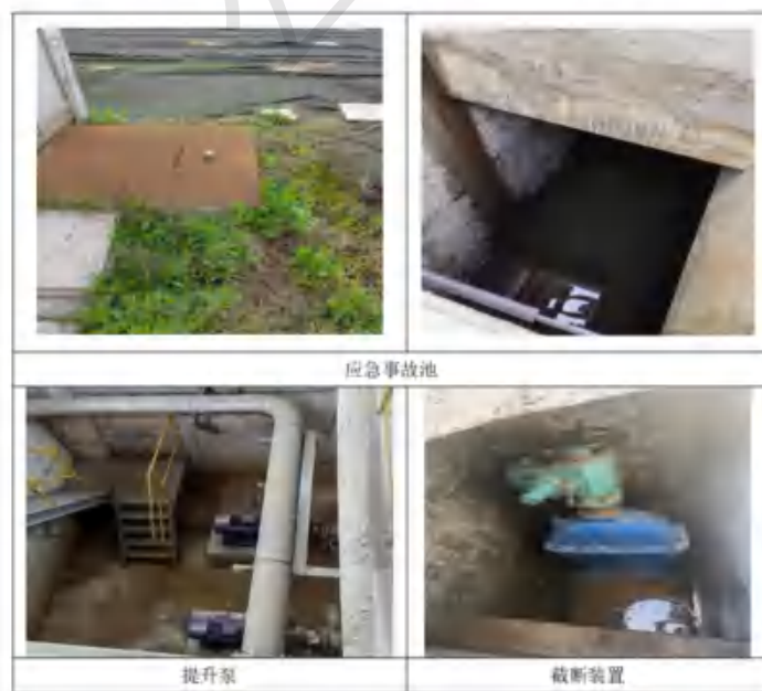
图 6.6-2 事故应急池及提升设施
